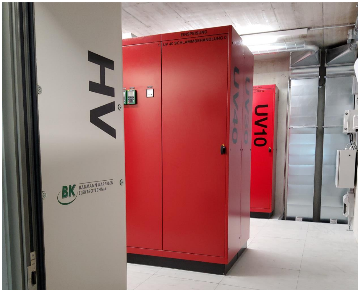
Abbildung 1 Einblick in den Elektroraum
