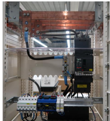
Abbildung 3 Eingang PV / St. NA-Schutz
